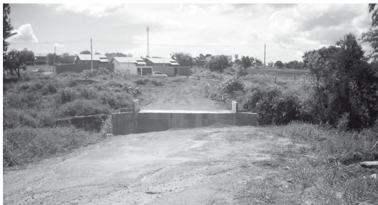
Bueiro a 60 metros acima da travessia entre o Serrinha e Caldas do Oeste, de um lado a rua ainda não foi aberta
