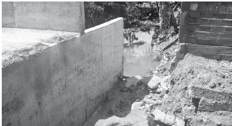
Aterro do bueiro entre o Jardim dos Buritis e Caldas do Oeste, está sendo levado pela chuva
