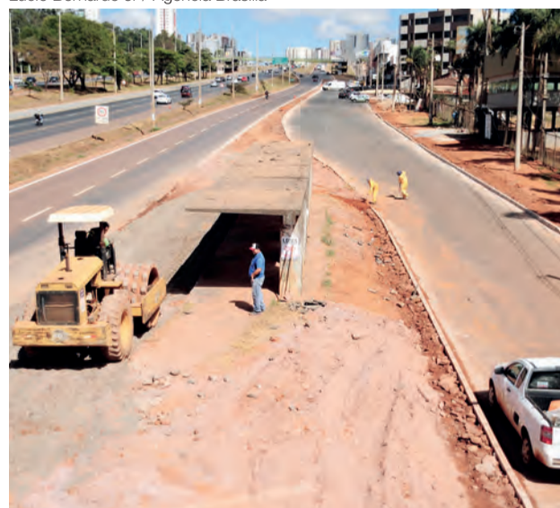
Córrego Samambaia: obras para estabilização da área que sofre com degradação, fazem parte das metas prioritárias do GDF
