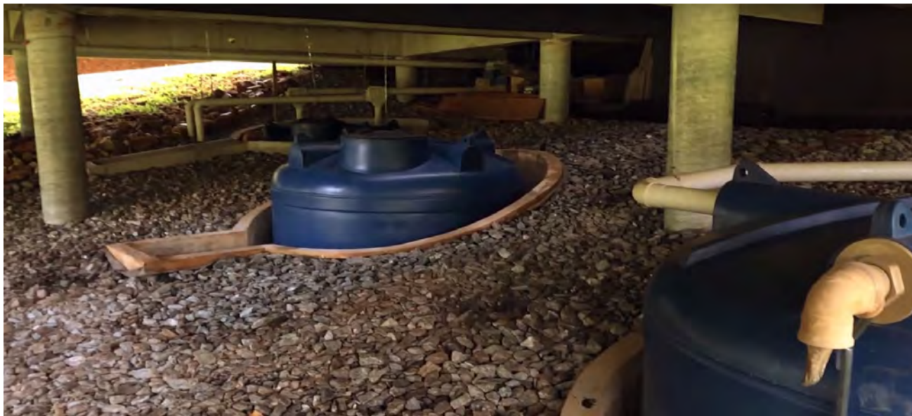
Reservatórios semi-enterrados da casa de Ana Maria, no Residencial Aldeia do Vale
