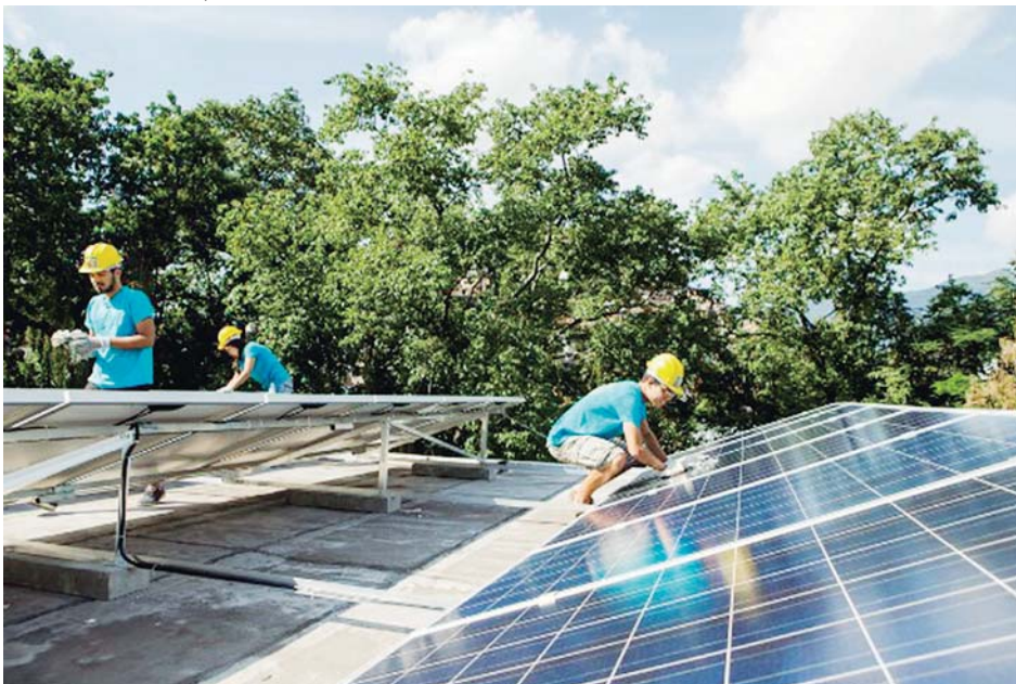
Jovens instalam placas solares no telhado em Vila Isabel, Rio de Janeiro/RJ
